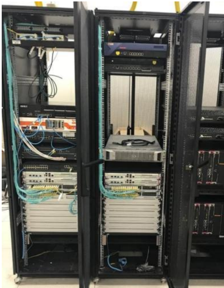
交换机端口通过长跳线
