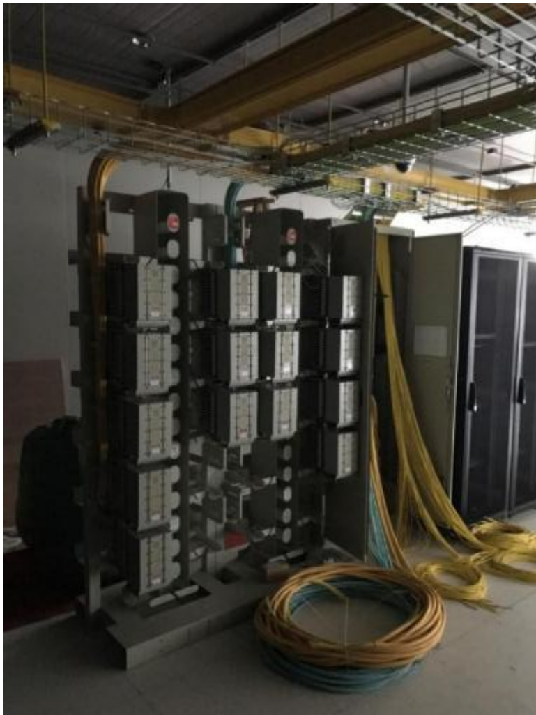
NGF尾缆及大楼主干进入OMX柜
